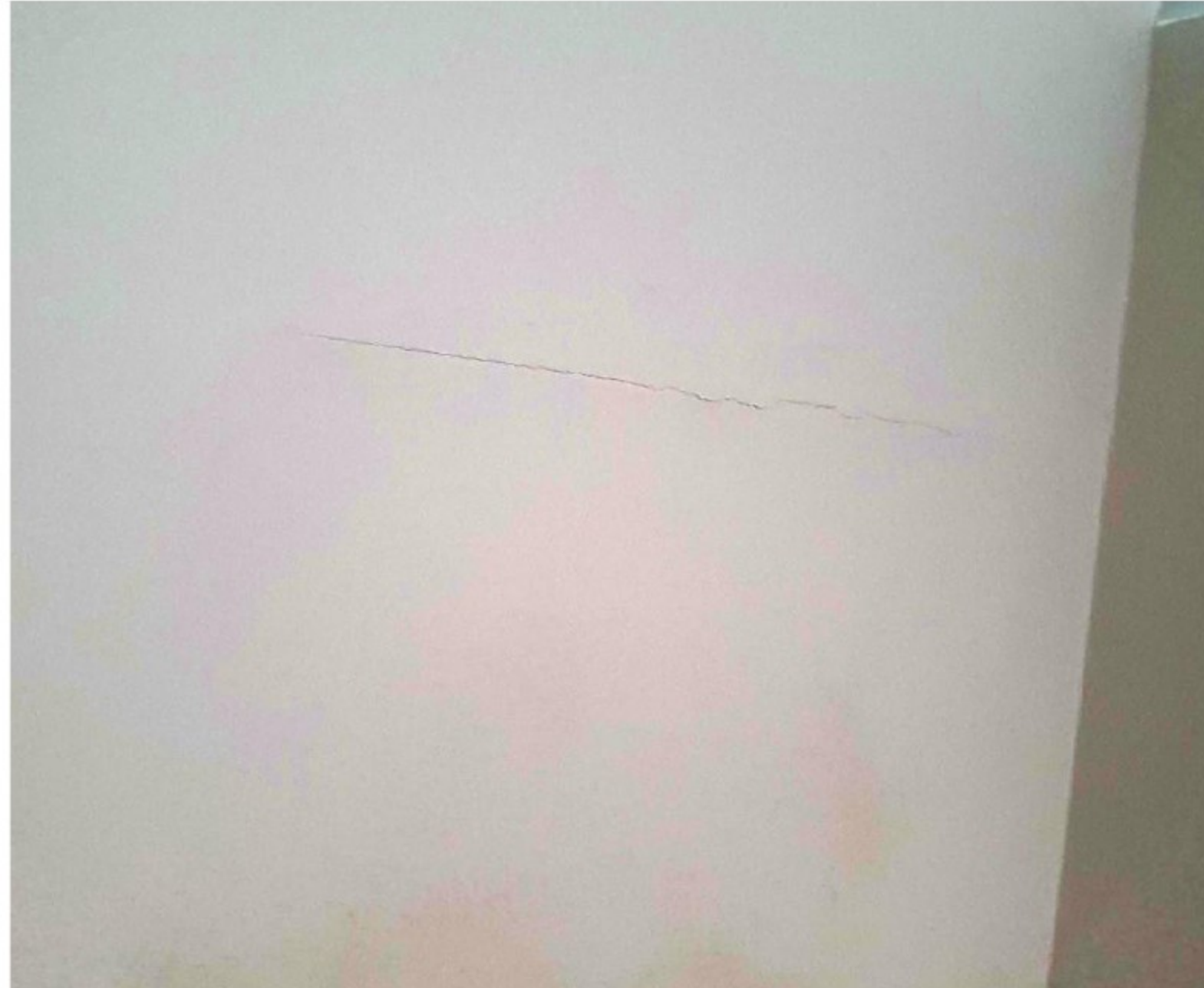
Foto 13 Agravamiento de la fisura asociada
