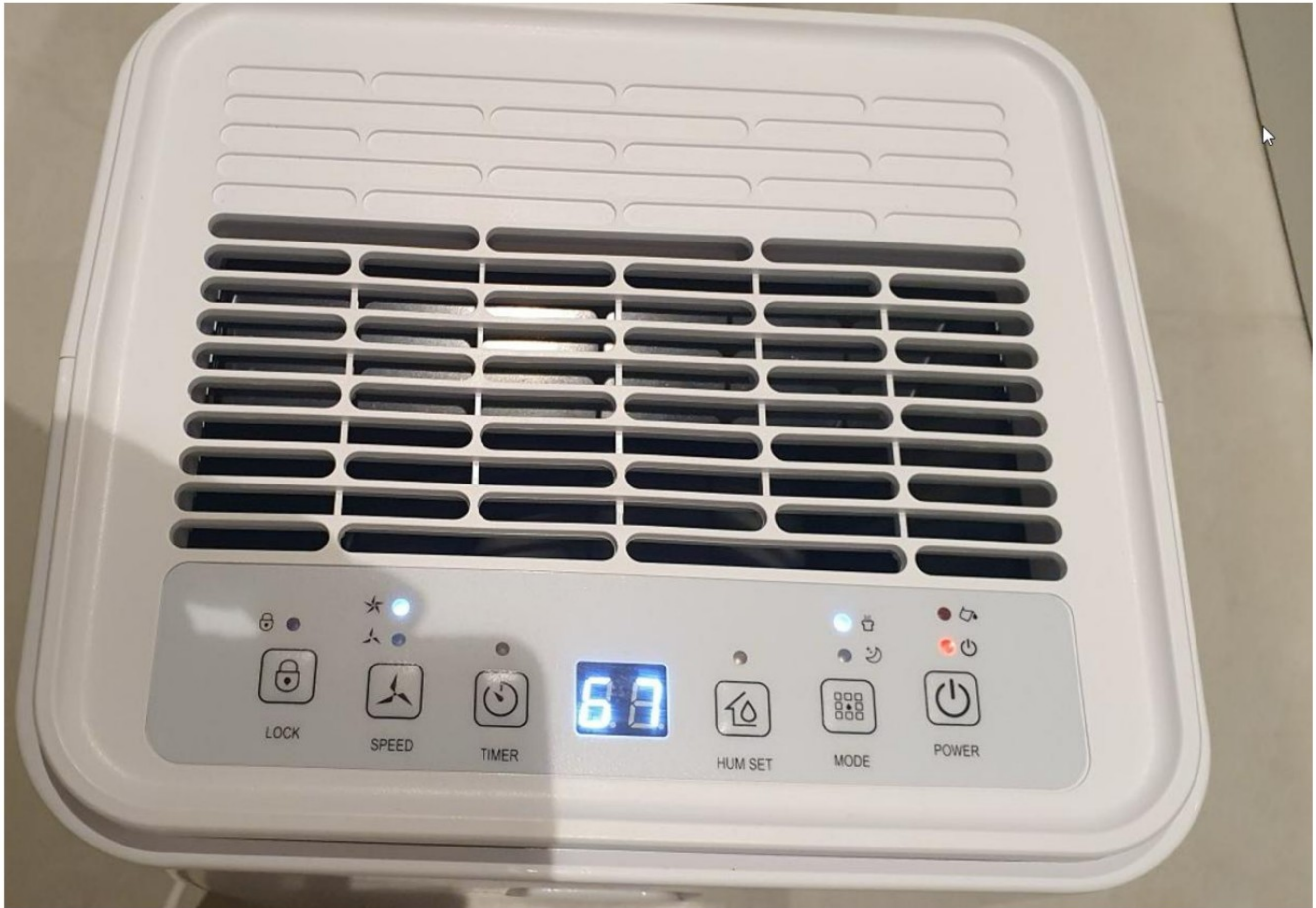
Foto 18 Equipo deshumidificador instalado en sótano
