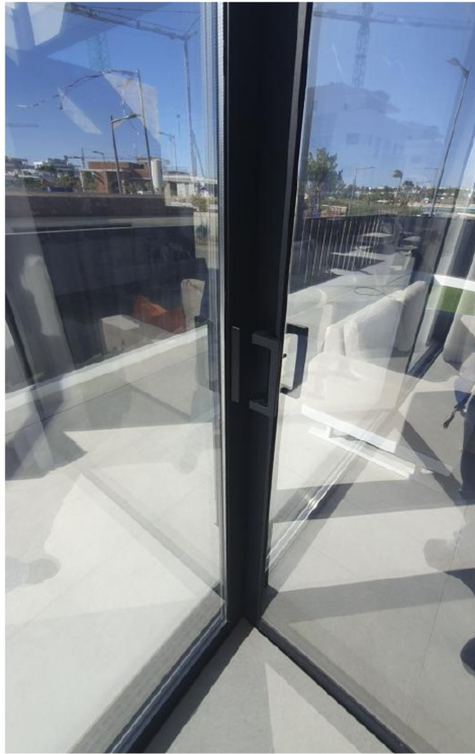
Foto 01 Sistema de cierre en esquina de carpintería corredera con dificultad de accionamiento.
